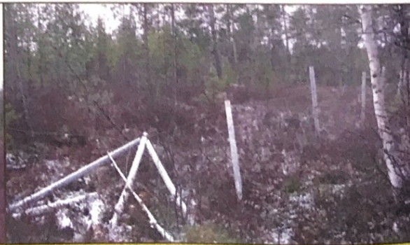
Фрагмент старого участка забора нуждается в реставрации. Природный резерват «Пасвик». Фото Г. Дмитриенко. Fragment of old fence in need for renovation. Natural Reserve Pasvik. Photo G. Dmitriyenko
